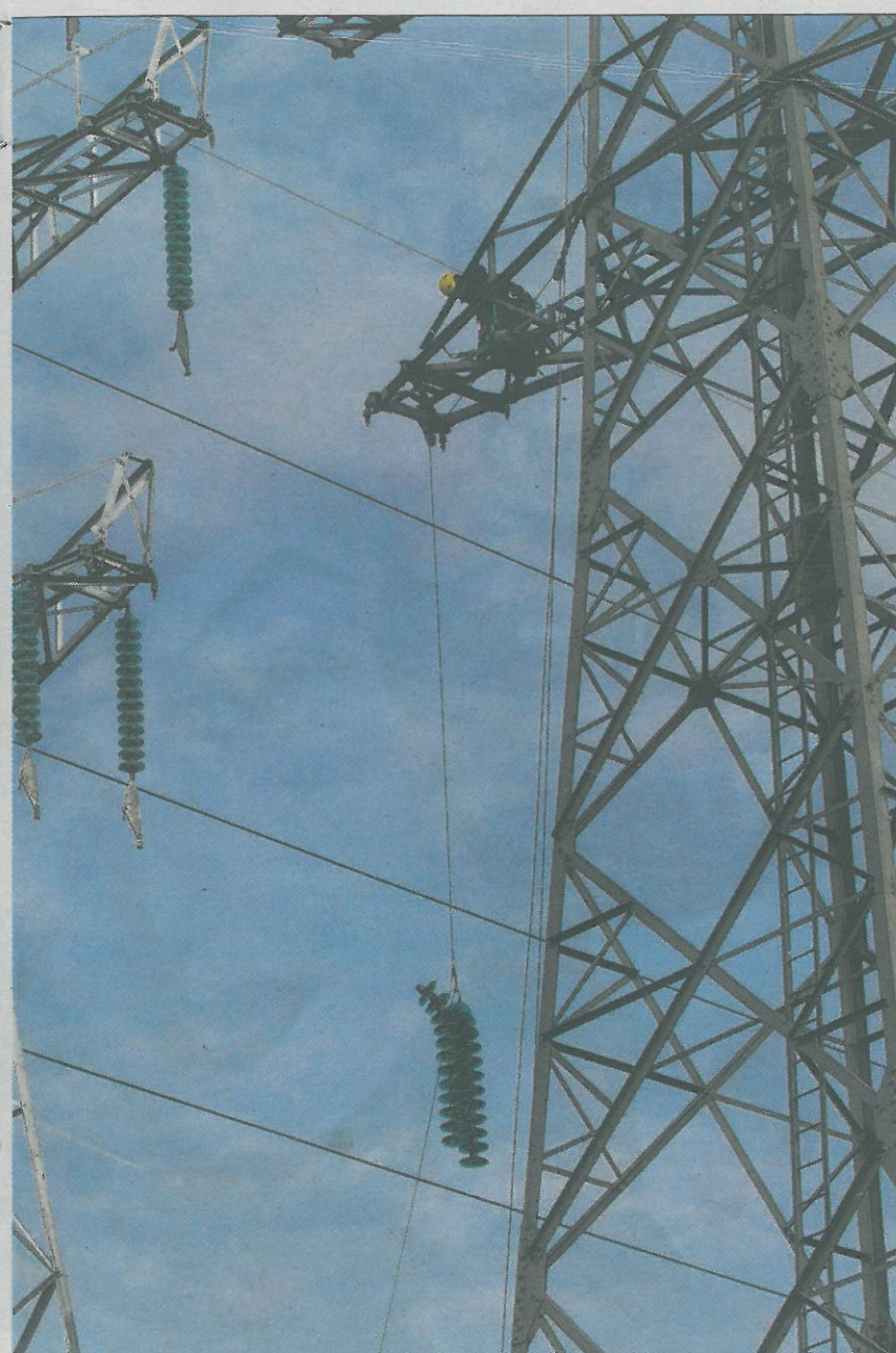
■ De dijkverlegging op de Voorsterklei werpt zijn schaduw vooruit. Aan de Voorsterklei is een beter verankerde hoogspanningsmast geplaatst die stand moet houden als het gebied volstroomt. foto Ronny te Wechel
